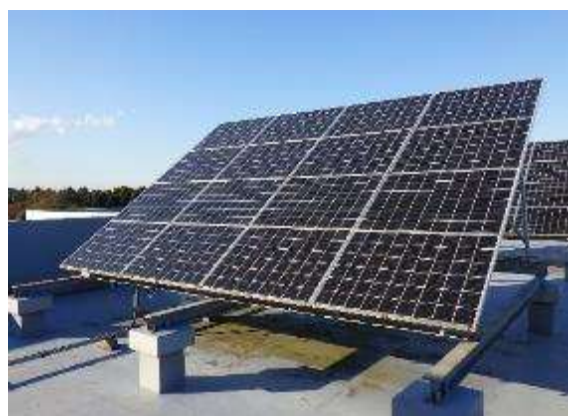
太陽光発電設備（第五中学校）
