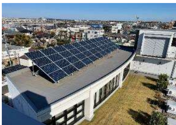
太陽光発電設備（消防本部）
