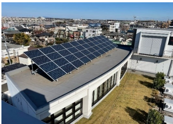
太陽光発電設備（消防本部）
