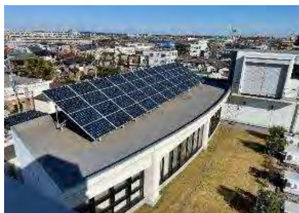
太陽光発電設備（消防本部）
