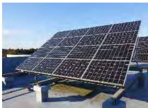
太陽光発電設備（第五中学校）
