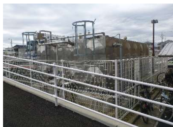
機械 給排水設備（受水槽）
