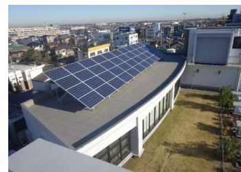
電気 太陽光発電設備
