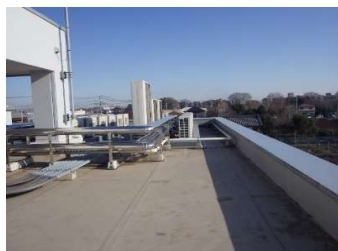
機械 空調設備（屋上 室外機）
