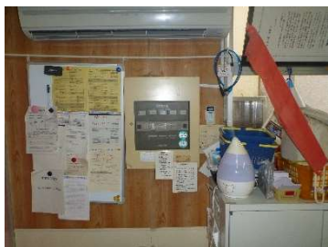
電気 防災設備
