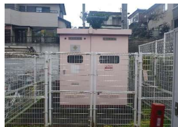
電気 受変電設備
