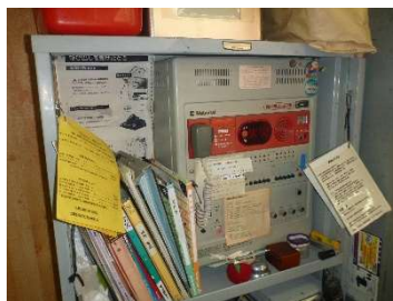
電気 防災設備
