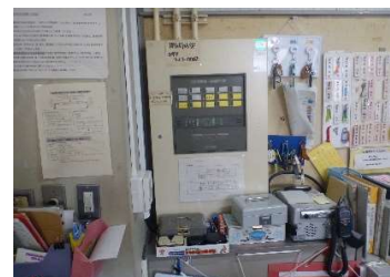
電気 防災設備
