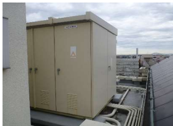
電気 受変電設備
