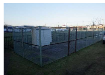
機械 給排水設備（浄化槽）
