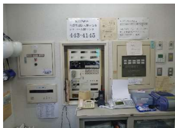
電気 防災設備
