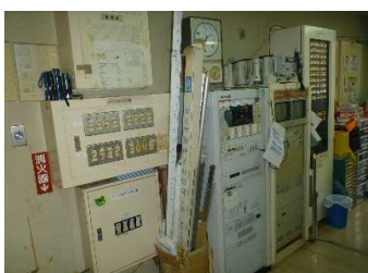
電気 防災設備
