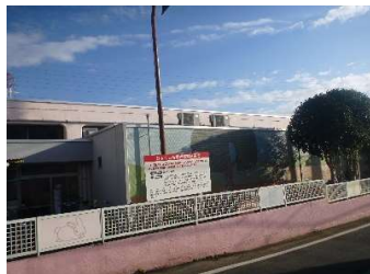
機械 空調設備（屋上 室外機）
