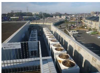
機械 空調設備（屋上 室外機）
