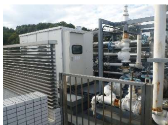
機械 空調設備（屋上 室外機）
