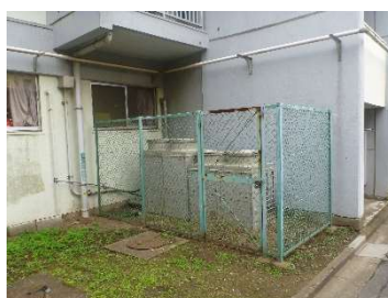
機械 空調設備（屋外 室外機）
