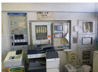
電気 防災設備
