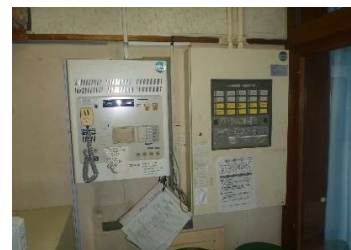
電気 防災設備
