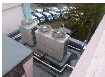
機械 空調設備（屋上 室外機）
