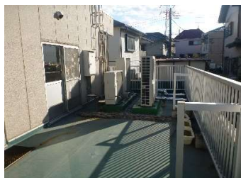
機械 空調設備（屋上 室外機）
