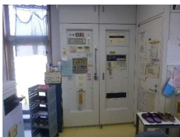
電気 防災設備
