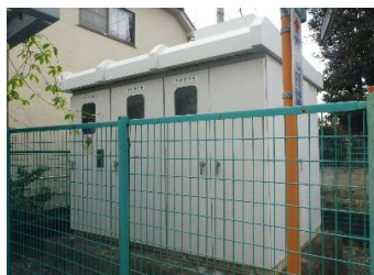
電気 受変電設備
