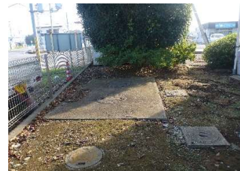
機械 給排水設備（浄化槽）
