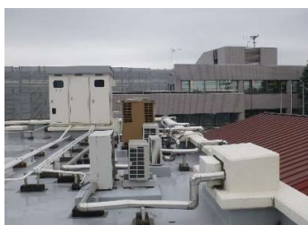
機械 空調設備（屋上 室外機）
