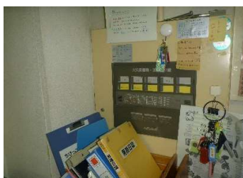
電気 防災設備
