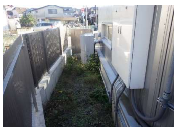
機械 空調設備（屋外 室外機）
