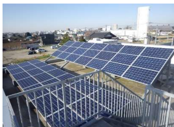
電気 太陽光発電設備
