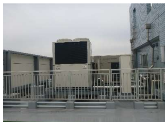
機械 空調設備（屋上 室外機）
