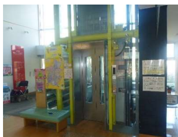
電気 昇降設備
