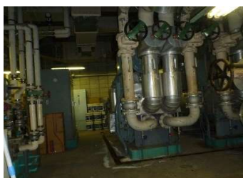
機械 空調設備（地下 機械室）
