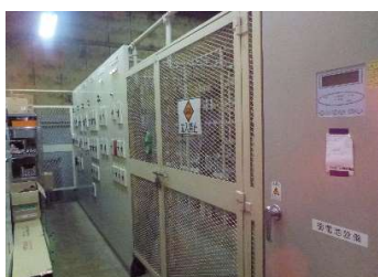
電気 受変電設備
