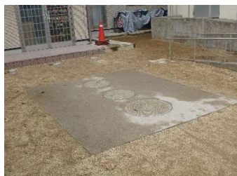
機械 給排水設備（浄化槽）
