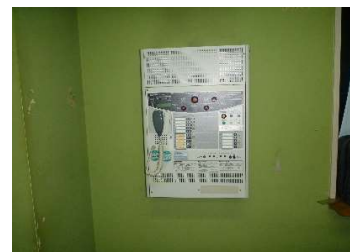
電気 防災設備
