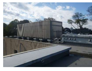
機械 空調設備（屋上 室外機）
