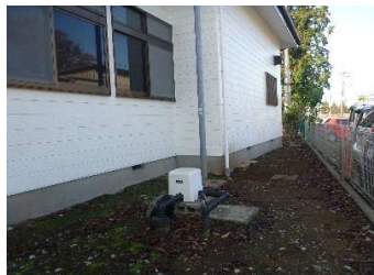
機械 給排水設備（井戸ポンプ）
