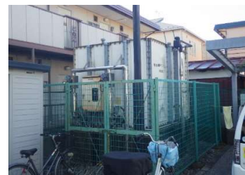
機械 給排水設備（受水槽）
