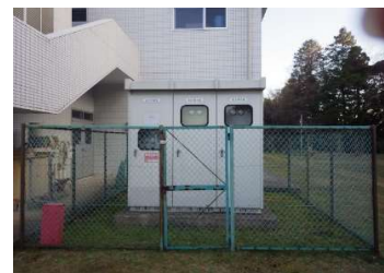
電気 受変電設備
