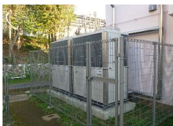
機械 空調設備（屋外 室外機）
