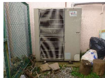
機械 空調設備（屋外 室外機）
