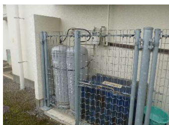
機械 ガス設備（屋外 プロパン庫）
