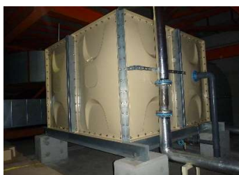
機械 給排水設備（屋内 高架水槽）
