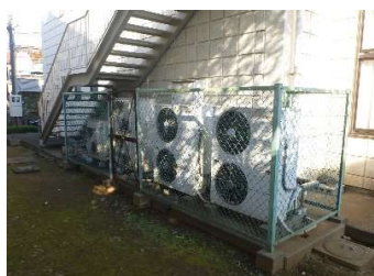
機械 空調設備（屋外 室外機）
