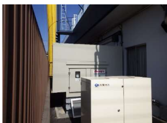
電気 非常用発電設備
