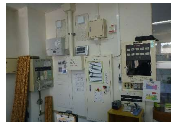
電気 防災設備
