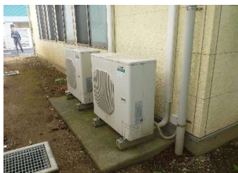
機械 空調設備（屋外 室外機）
