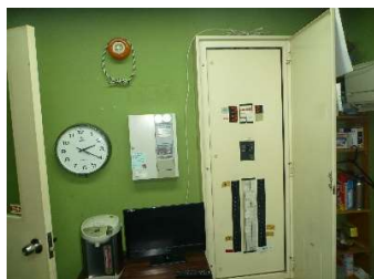
電気 防災設備
