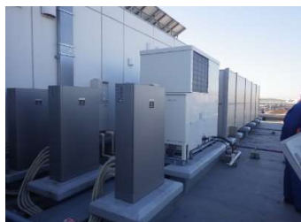
機械 空調設備（屋外 室外機）
