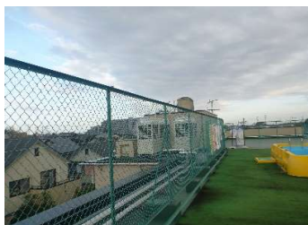
機械 空調設備（屋上 室外機）
