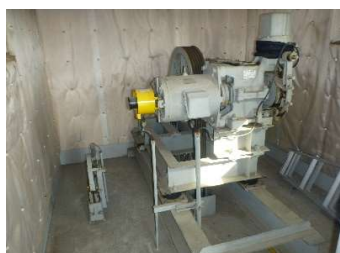
電気 昇降設備（機械室）
