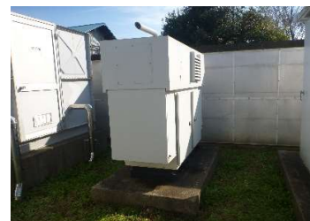
電気 非常用発電設備
