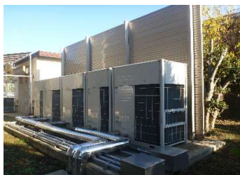
機械 空調設備（屋外 室外機）
