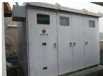
電気 受変電設備
