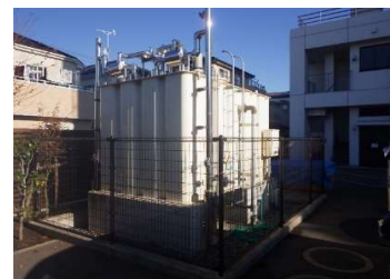
機械 給排水設備（受水槽）
