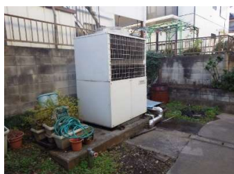
機械 空調設備（屋外 室外機）
