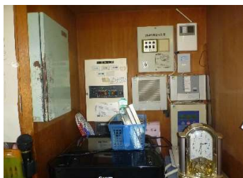
電気 防災設備
