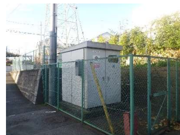
電気 受変電設備
