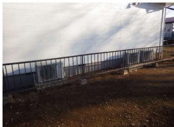
機械 空調設備（屋外 室外機）
