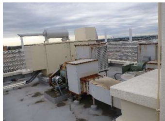
電気 非常用発電設備
