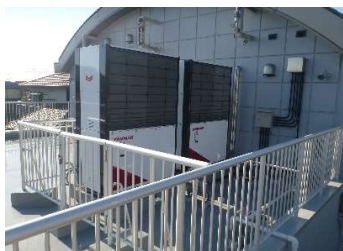
機械 空調設備（屋上 室外機）
