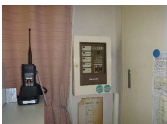
電気 防災設備
