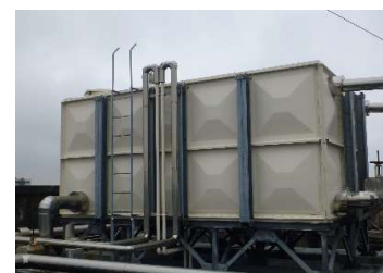
機械 給排水設備（高架水槽）
