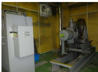
電気 昇降設備（機械室）
