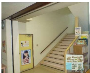
建築 内部（防火シャッター）
