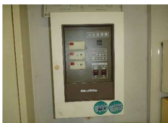
電気 防災設備
