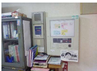
電気 防災設備
