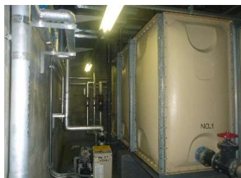
機械 給排水設備（屋内 受水槽）
