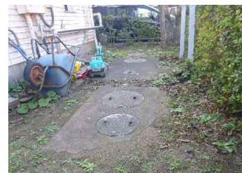
機械 給排水設備（浄化槽）
