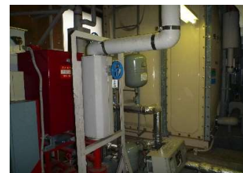
機械 給排水設備（屋内 受水槽、給水ポンプ）
