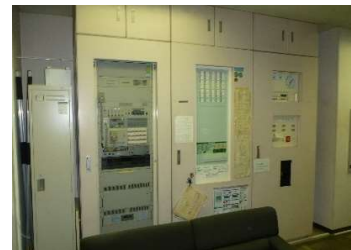
電気 防災設備
