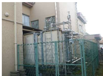
機械 給排水設備（受水槽）
