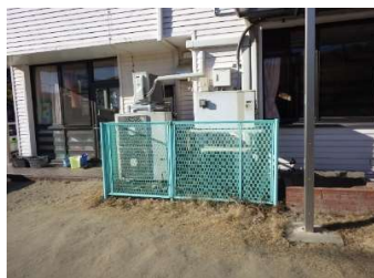
機械 空調設備（屋外 室外機）
