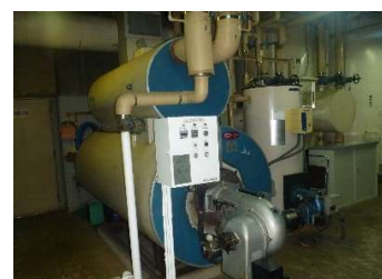
機械 空調設備（機械室）
