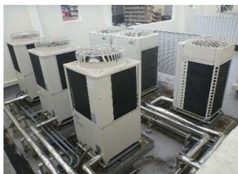
機械 空調設備（屋外 室外機）
