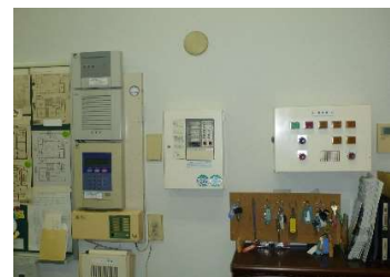
電気 防災設備
