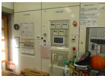
電気 防災設備
