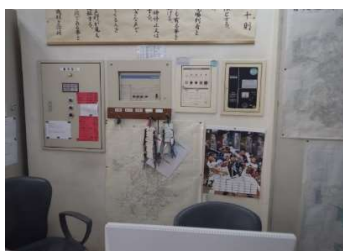
電気 防災設備
