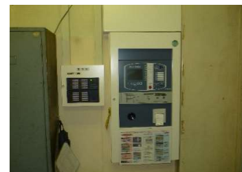
電気 防災設備
