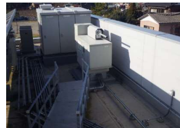
電気 受変電設備、非常用発電設備
