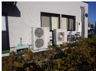
機械 空調設備（屋外 室外機）
