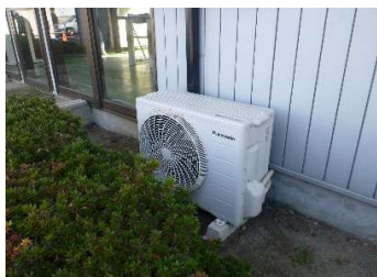
機械 空調設備（屋外 室外機）
