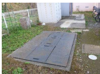
機械 給排水設備（浄化槽）
