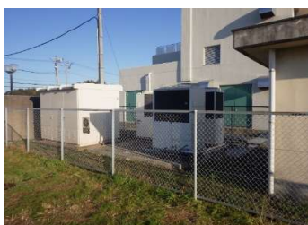
機械 空調設備（屋外 室外機）
