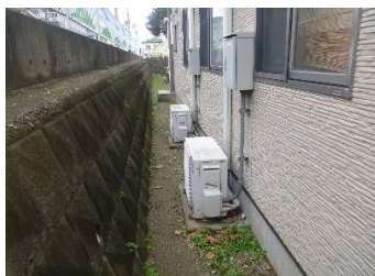
機械 空調設備（屋外 室外機）
