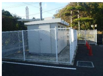
電気 受変電設備
