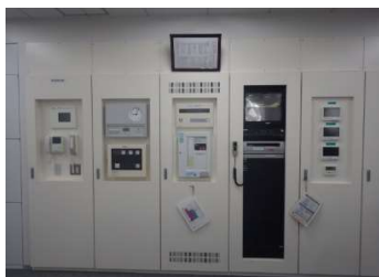
電気 防災設備
