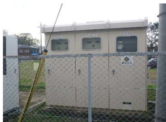
電気 受変電設備
