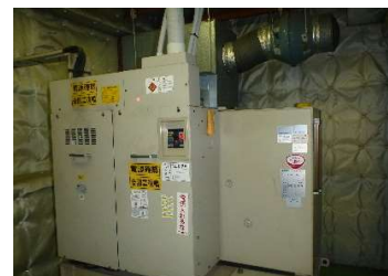
電気 昇降設備（機械室）
