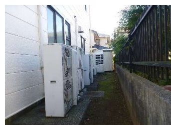
機械 空調設備（屋外 室外機）
