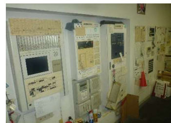
電気 防災設備
