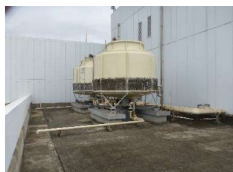
機械 空調設備（屋上 冷却塔）
