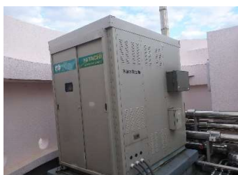
機械 空調設備（屋上 冷温水発生機）
