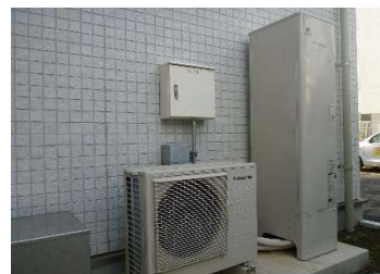
機械 空調設備（屋外 室外機）
