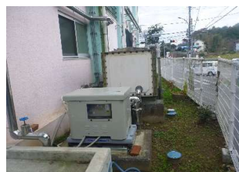
機械 給排水設備（受水槽・加圧ポンプ）
