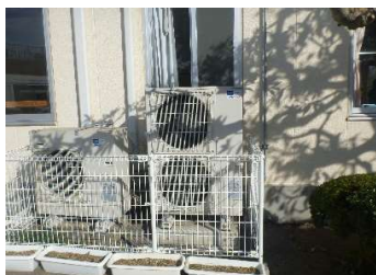
機械 空調設備（屋上 室外機）
