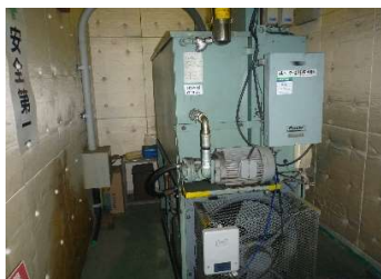
電気 昇降設備（機械室）
