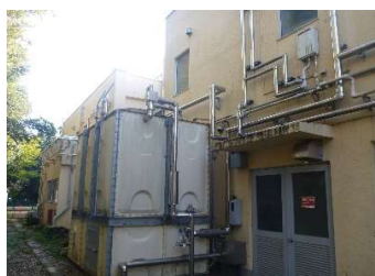
機械 給排水設備（受水槽）
