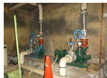
機械 給排水設備（揚水ポンプ）
