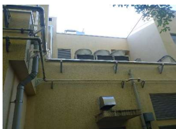
機械 空調設備（屋上 室外機）
