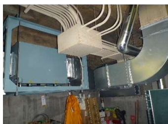
機械 換気設備（機械室）
