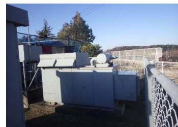
電気 非常用発電設備
