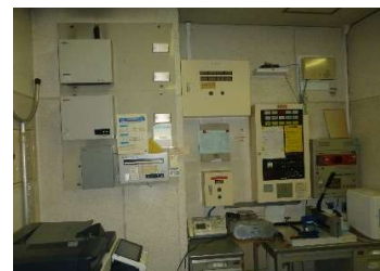
電気 防災設備
