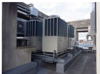
機械 空調設備（屋上 室外機）
