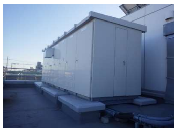
電気 受変電設備
