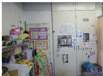
電気 防災設備
