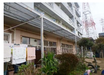
建築 外部（落下物防止柵）
