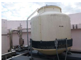
機械 空調設備（屋上 冷却塔）
