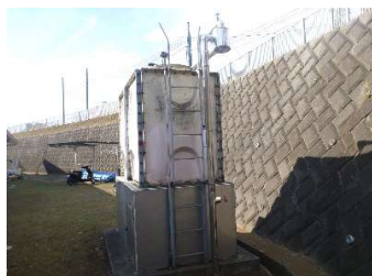
機械 給排水設備（受水槽）
