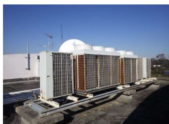
機械 空調設備（屋外 室外機）
