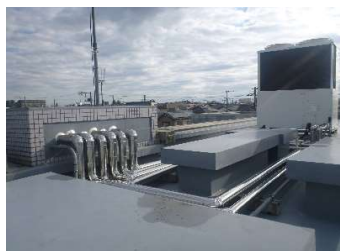
機械 空調設備（屋上 室外機）
