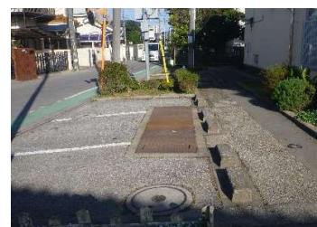
機械 給排水設備（浄化槽）
