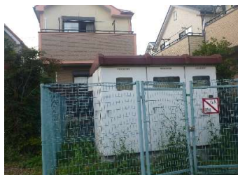
電気 受変電設備
