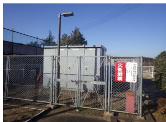
電気 受変電設備
