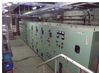
電気 受変電設備
