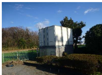
機械 給排水設備（受水槽）
