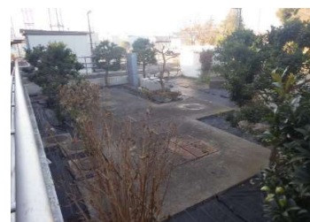
機械 給排水設備（浄化槽）
