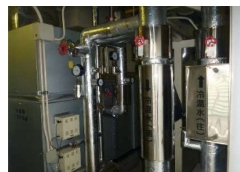
機械 空調設備（機械室）
