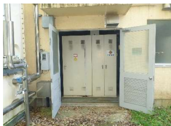
電気 受変電設備
