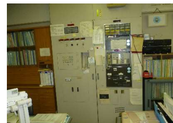
電気 防災設備
