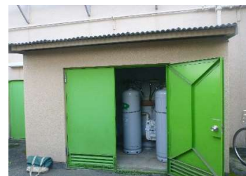
機械 ガス設備（プロパン庫）
