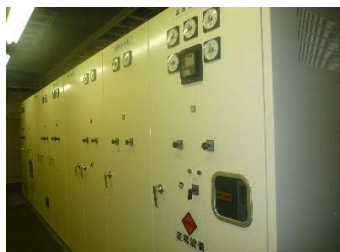
電気 受変電設備
