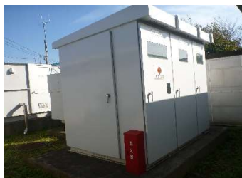
電気 受変電設備
