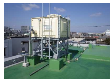
機械 給水設備（高架水槽）
