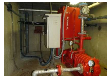
機械 給排水設備（消火ポンプ）
