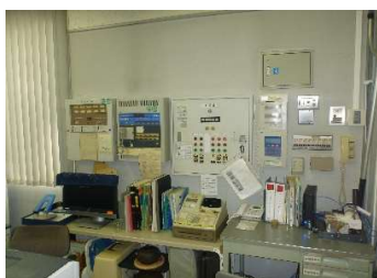
電気 防災設備
