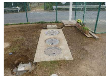
機械 給排水設備（浄化槽）
