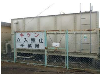
機械 給排水設備（受水槽）
