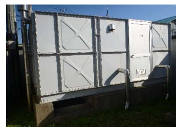
機械 給排水設備（受水槽）
