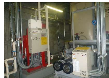
機械 消防設備（屋内 消火ポンプ）
