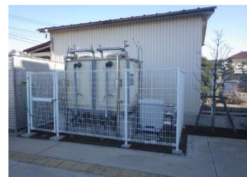
機械 給排水設備（受水槽）
