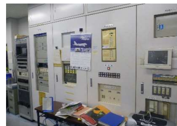
電気 防災設備
