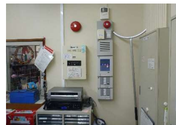
電気 防災設備
